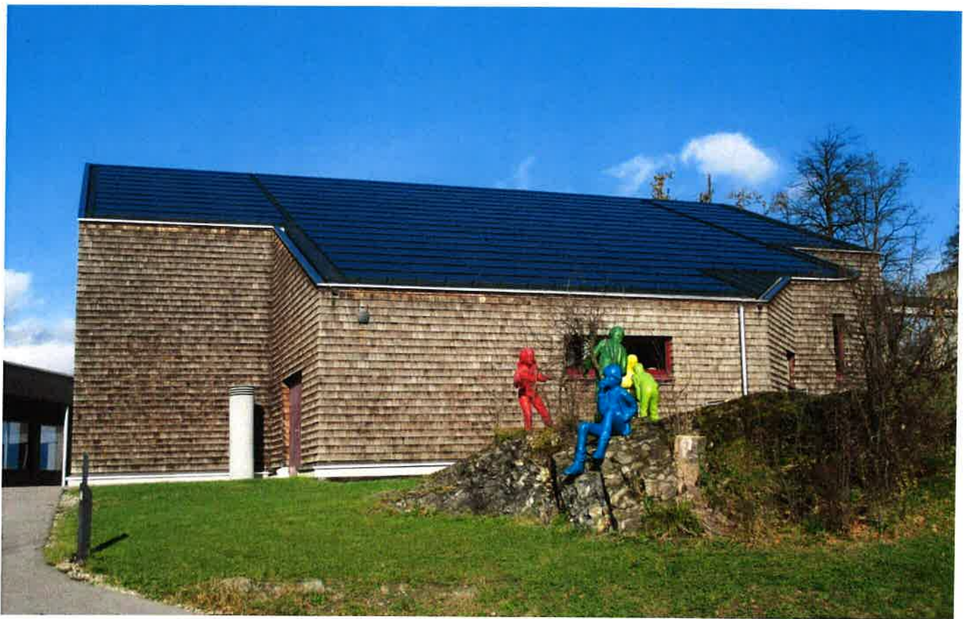
Photovoltaikanlage (Turnhalle der Primarschule Gamprin)
