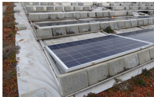
Bild 4: Ungeeignetes Befestigungssystem. Die Fläche unter der Anlage ist nicht zugänglich und wurde deshalb teilweise mit einer Folie abgedeckt. So sieht keine gute Lösung aus.
